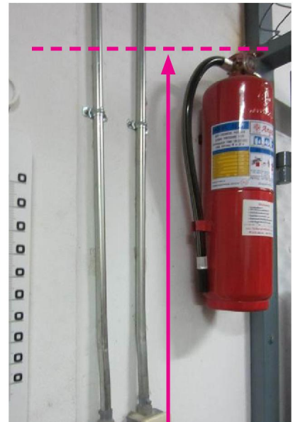
ติดตั้งสูงจากพื้นไม่เกิน 150 เซนติเมตร
